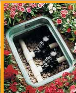
K ventilům musí být přístup.
